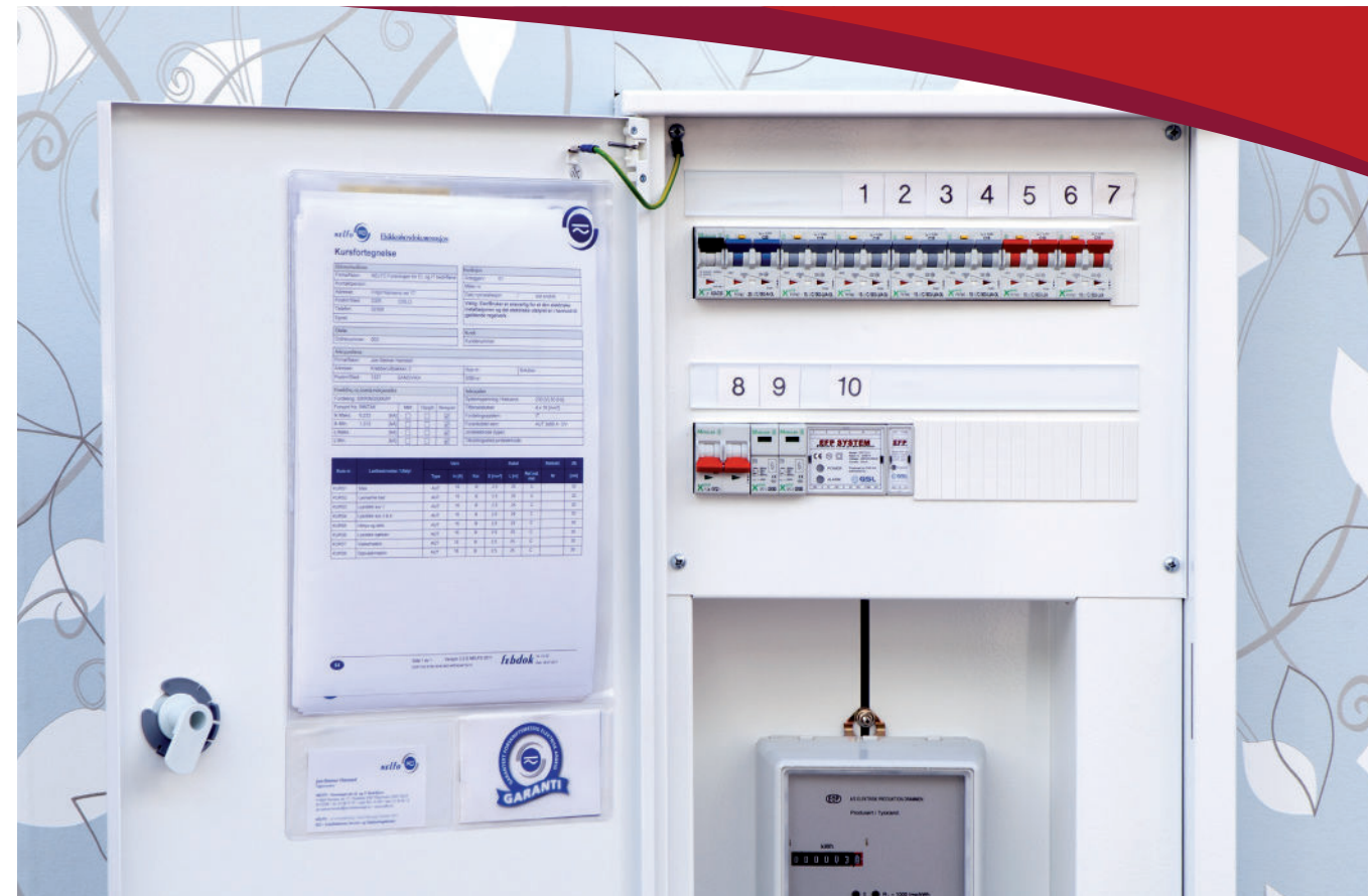
Slik skal et moderne sikringsskap være, med automatsikringer, overspenningsvern og jordfeilbryter.
